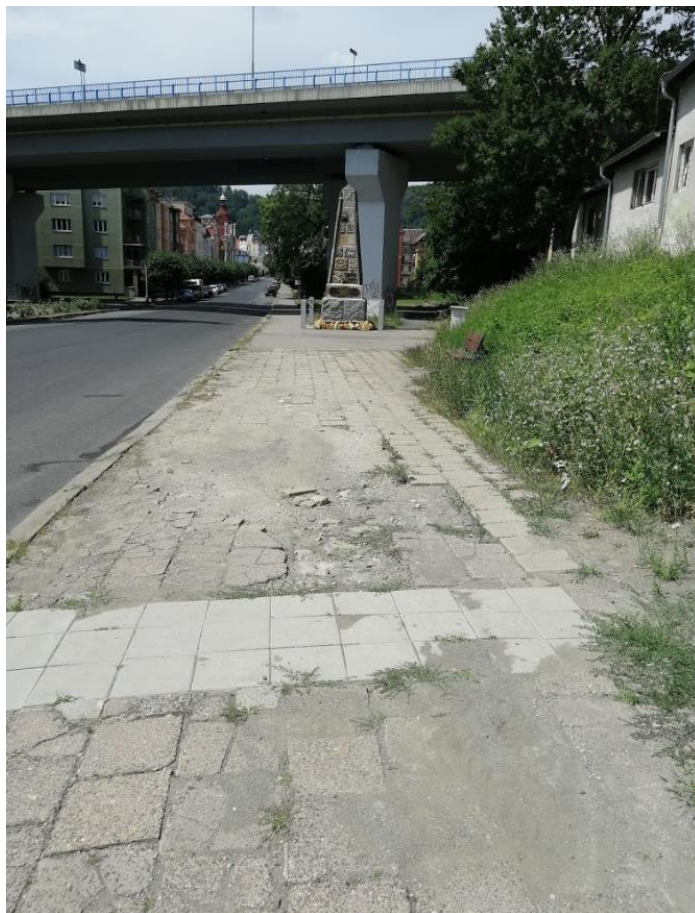
Obrázek 28 Stav chodníku na ul. 17. listopadu (zdroj: RHDHV)
